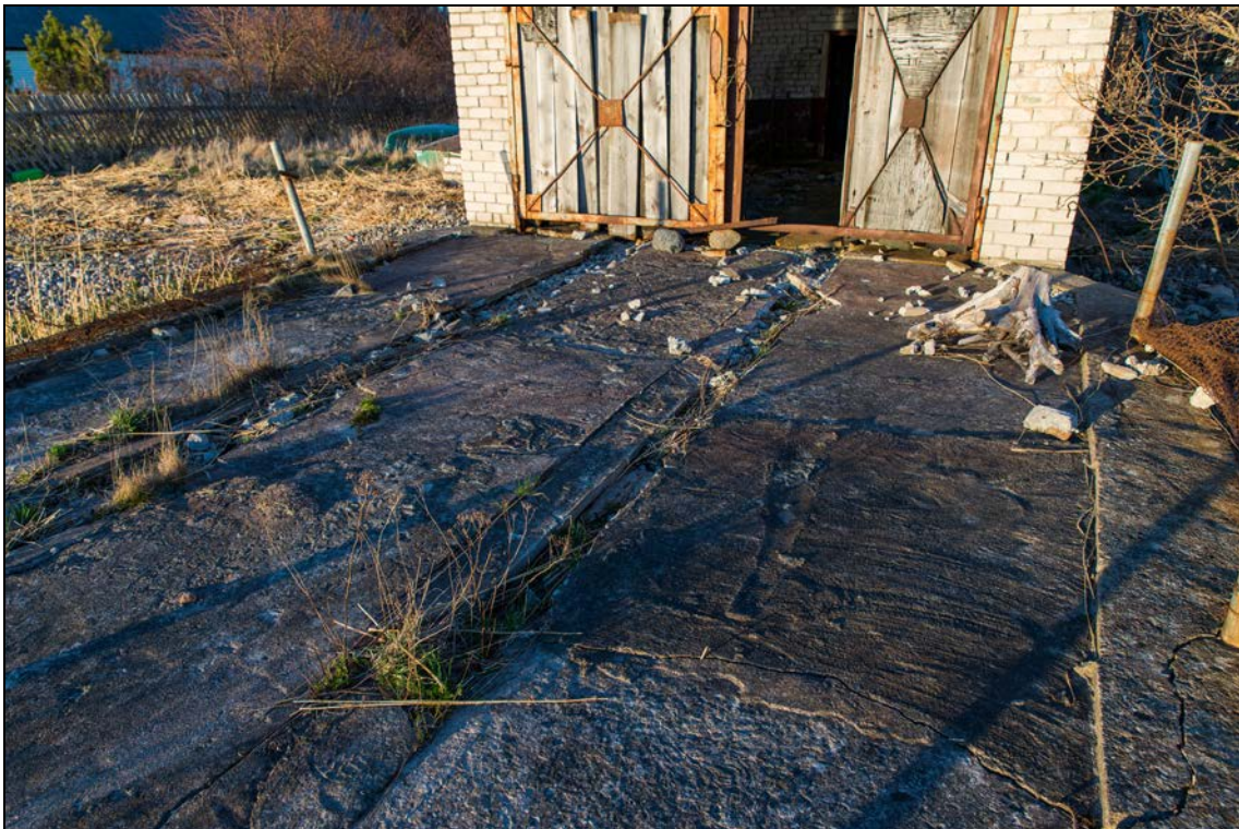
Foto 9 (476). Leesi tehnilise vaatluse post. Prožektori relsid on betoonist siiski välja kangutatud. Foto Mart Mõniste 23.04.2014.
